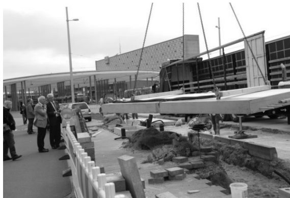
Rys. 5. Moment instalowania płyty ładującej w przystanek przy kolejowym dworcu głównym w Brunshwiku.
